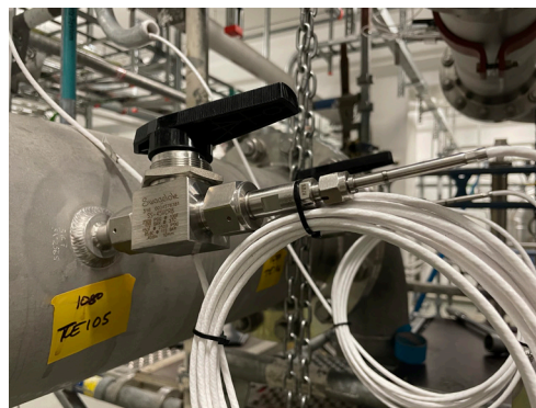
Temperaturgivaren installerad i processen.
